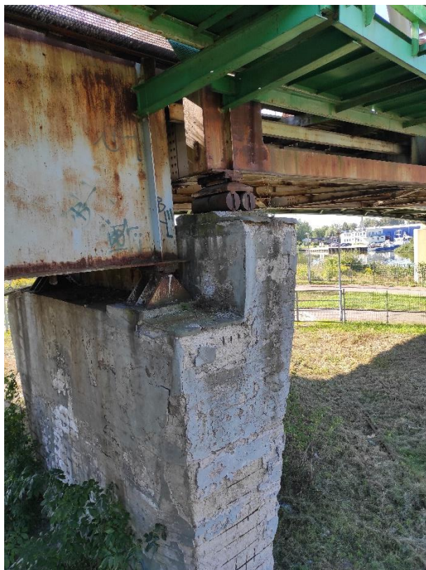
Rys. 3.0 – Widok z boku. Korozja stali, ubytki betonu ciosu podłożyskowego.
