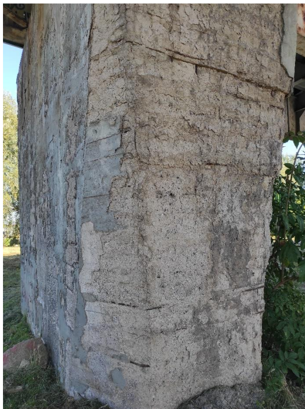
Rys. 2.0 – Widok z boku. Lokalne ubytki betonu z odsłoniętymi i skorodowanymi prętami.
