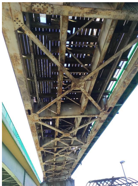
Rys. 4.0 – Widok na spód przęsła kratowego. Korozja powierzchniowa z ogniskami korozji wżerowej na elementach jezdni.
