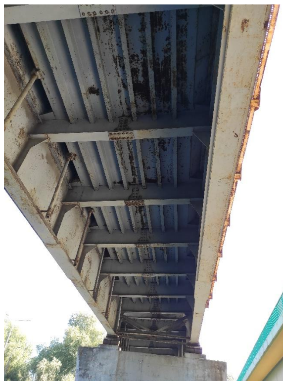
Rys. 4.0 – Widok na spód przęsła blachownicowego. Korozja powierzchniowa z ogniskami korozji wżerowej na spodzie blachy płyty.
