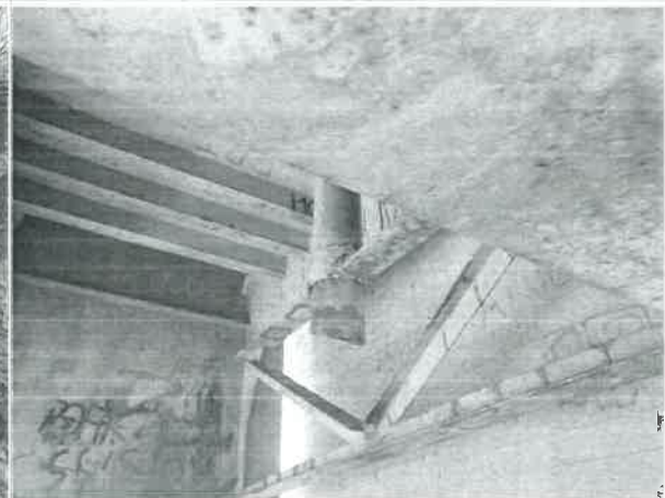
4. Widok na uszkodzenie systemu odwodnienia przy przyczółku
