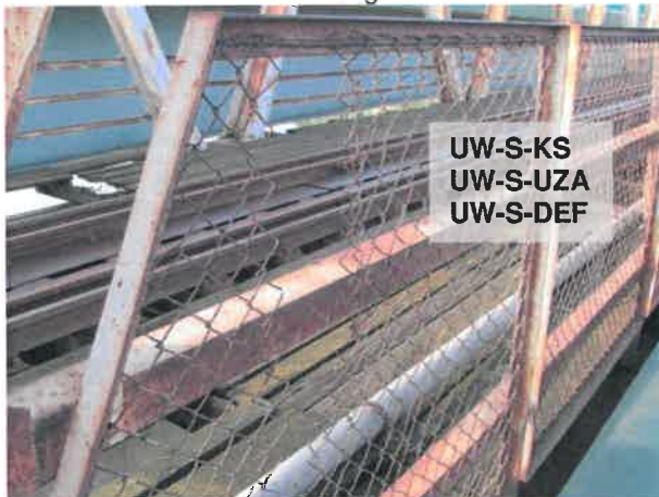
Fot. 31 Zdeformowana i skorodowana osłona poręczy od strony kładki dla pieszych.
