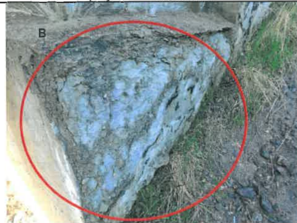
Fot. 15 Widok na przyczółek zachodni. Znaczny ubytek betonu.
