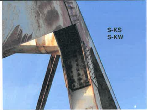
Fot. 11 Ogniska korozji wżerowej w węzłach kratownicy.
