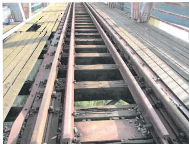
Fot. 3 Widok na nawierzchnię torową. Widoczne spękania i ubytki w drewnianych podkładach.
