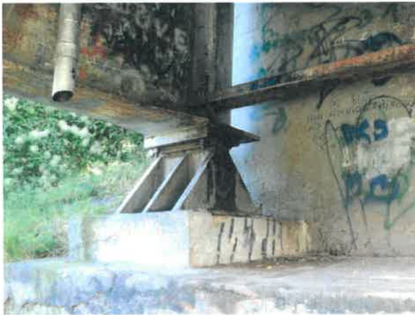
Fot. 22 Widok na łożysko stałe na przyczółku wschodnim, widoczne łuszczenie się powłoki malarskiej i korozja. Stwierdzono spękanie ciosu podłożyskowego.
