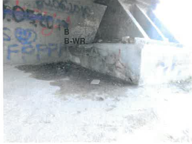
Fot. 23 Widok na cios podłożyskowy na przyczółku wschodnim- spękanie betonu ciosu.
