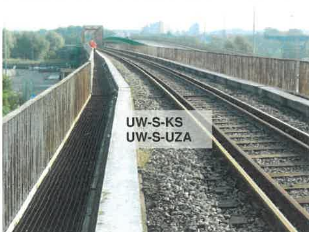
Fot. 27 Korozja powierzchniowa i lokalnie wżerowa całej poręczy po obu stronach obiektu.
