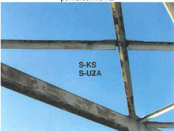
Fot. 8 Widok na pas górny kratownicy- korozja powierzchniowa stali i łuszczenie się powłoki malarskiej.
