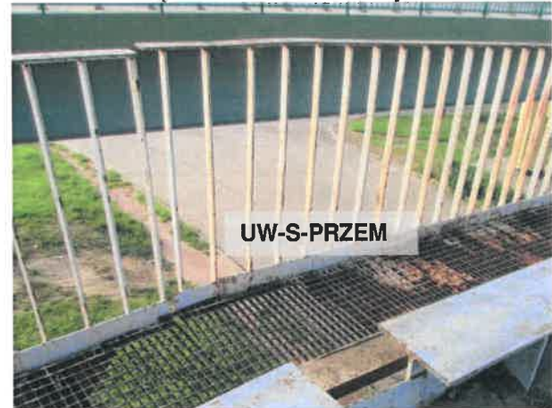
Fot. 32 Przemieszczenie konstrukcji wsporczej chodnika służbowego.
