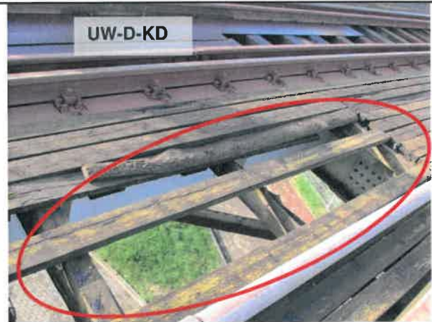
Fot. 30 Ubytki desek w dylinie mostu przęsła kratowego. Większość desek zbutwiałych.
