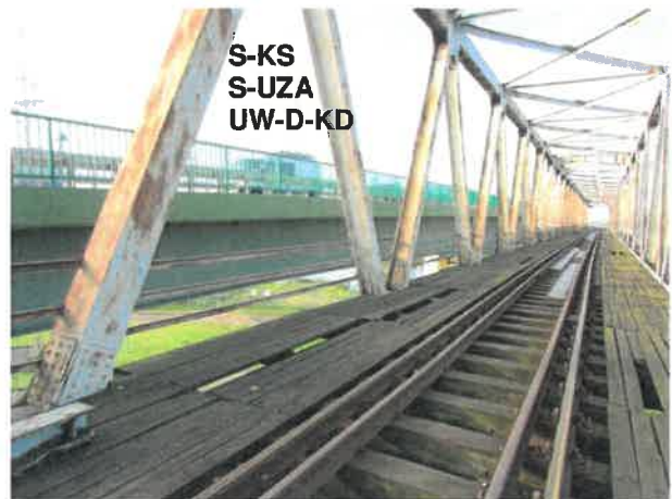
Fot. 9 Widok na nawierzchnię torową w kratownicy. Widoczne ubytki blach przeciwwykolejeniovych i przeciwpożarowych.
