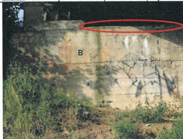
Fot. 14 Widok na korpus przyczółka zachodniego. Ubytek i spękanie w górnej części korpusu.
