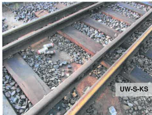
Fot. 33 Skorodowane pokrycie szczeliny dylatacyjnej.
