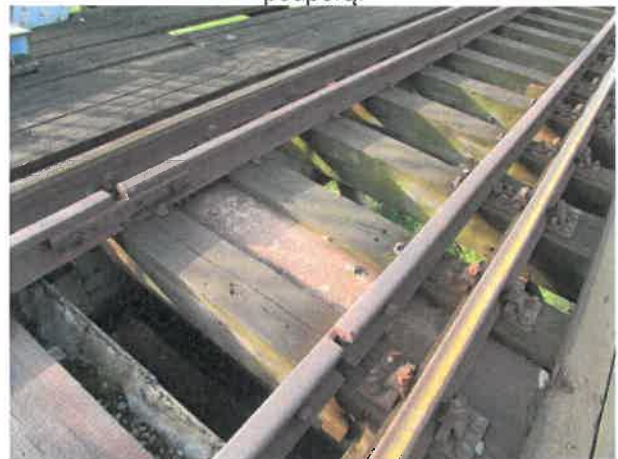
Fot. 7 Przerwanie ciągłości odbojnicy.
