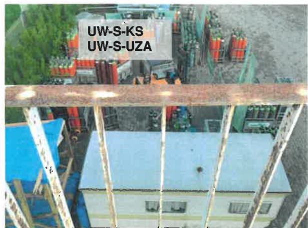
Fot. 28 Korozja powierzchniowa i lokalnie wżerowa poręczy.
