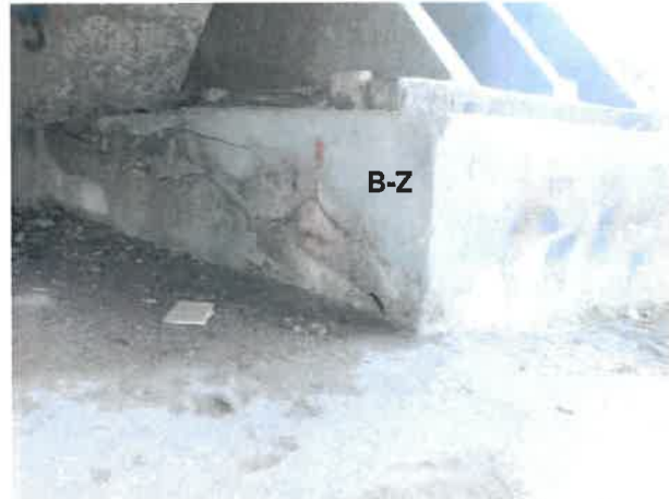
Fot. 13 Zanieczyszczenie lawy podłożyskowej na przyczółku wschodnim.
