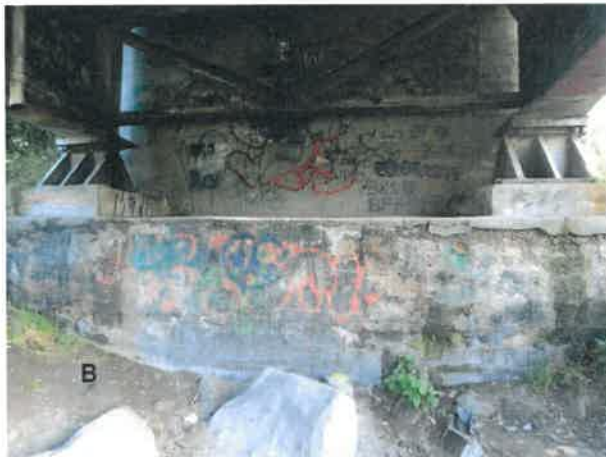
Fot. 12 Widok na przyczółek wschodni. Ubytki betonu, zacieki i zanieczyszczenia na powierzchni przyczółka.
