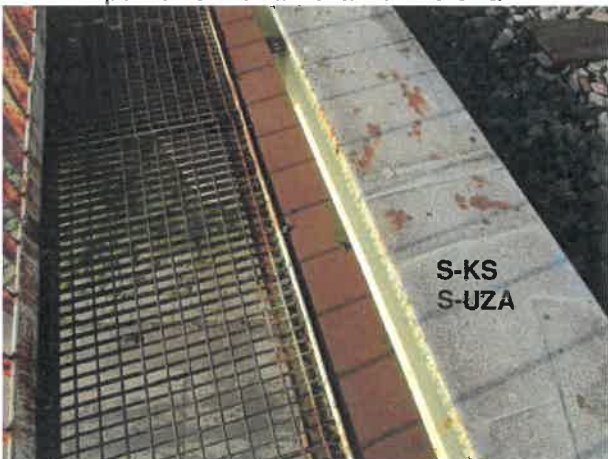
Fot. 6 Widok na pas górny blachownicy. Korozja powierzchniowa.
