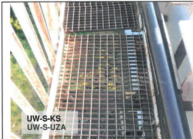
Fot. 29 Widok na skorodowane płyty ażurowe pomostu roboczego.
