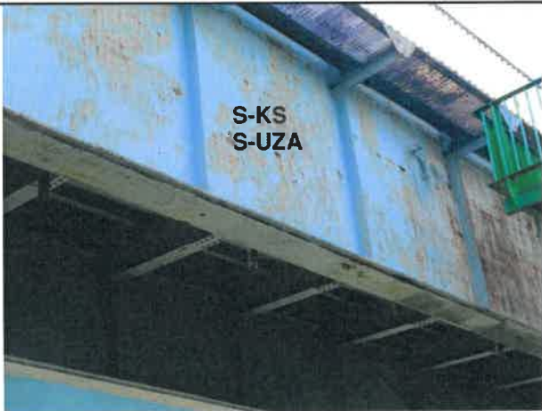
Fot. 10 Widok na blachownicę - najbardziej skorodowane są dolne pasy blachownicy.
