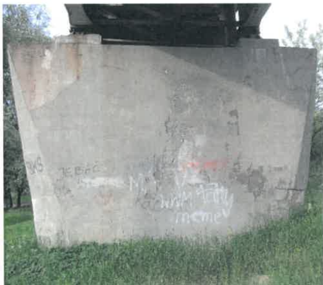
Fot. 158 Widok od strony Tropów. Graffiti obniżające estetykę. Spękania otuliny betonowej. Drobne osady i białe przebarwienia. Powierzchniowe ubytki wierzchniej warstwy betonu.
