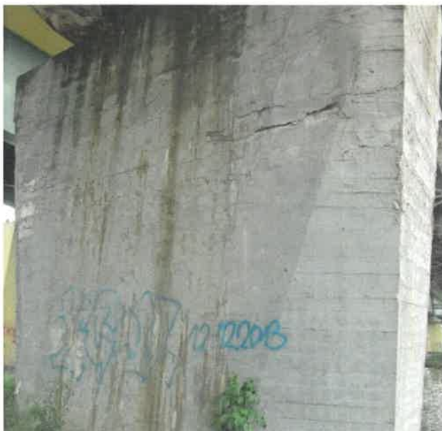
Fot. 146 Widok od strony Braniewa. Graffiti obniżające estetykę. Spękania otuliny betonowej. Osady i wykwyty na betonie.
