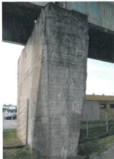
Fot. 133 Widok z prawej strony. Znaczne ubytki powierzchniowe z odkrytą siatką zbrojenia.
