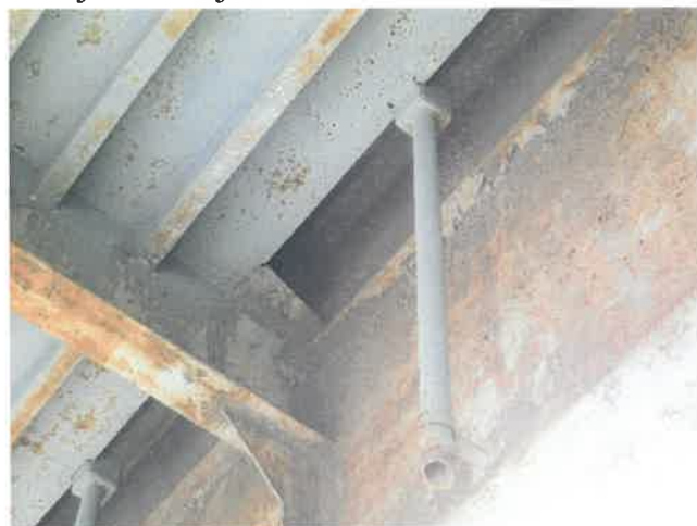
Fot. 49 Widok na środnik dźwigara lewego przęsła 16. Łuszczenie powłoki malarskiej z korozją powierzchniową i drobnymi ogniskami korozji wżerowej.
