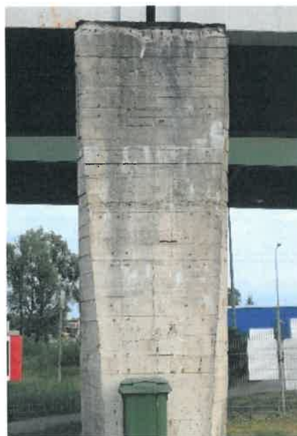
Fot. 135 Widok z lewej strony. Osady na betonie, białe przebarwienia betonu.
