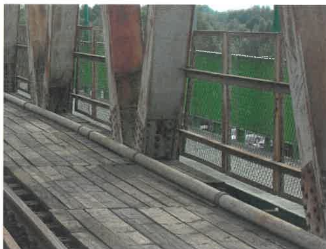
Fot. 185 Widok na rurę ochronną kabli SRK ułożoną na chodniku służbowym przęsła 11 kratowego.
