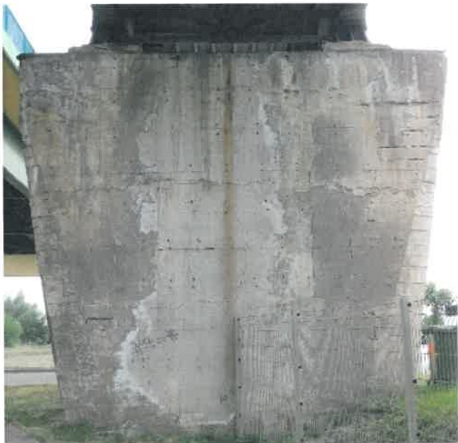
Fot. 132 Widok od strony Braniewa. Osady na betonie, białe przebarwienia betonu. Ubytki betonu wzdłuż korodujących prętów.
