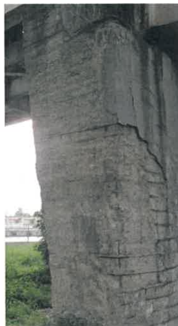
Fot. 149 Widok z prawej strony. Spękania otuliny betonowej. Znaczne ubytki powierzchniowe betonu z odkrytą siatką zbrojenia.
