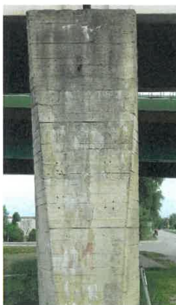
Fot. 124 Widok z lewej strony. Osady na betonie, białe przebarwienia betonu
