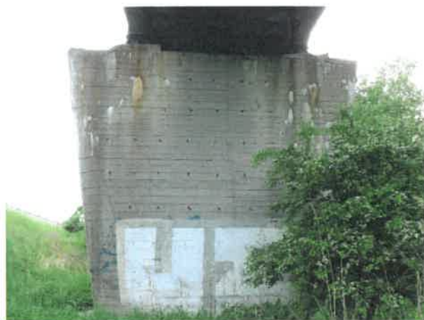
Fot. 105 Widok od strony Braniewa. Graffiti obniżające estetykę. Osady i wykwity na betonie, białe przebarwienia betonu.
