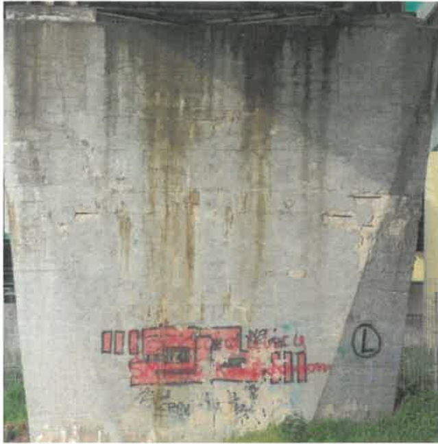
Fot. 144 Widok od strony Tropów. Graffiti obniżające estetykę. Spękania otuliny betonowej. Osady i wykwyty na betonie.
