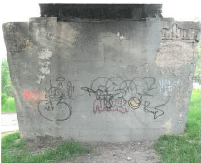
Fot. 162 Widok od strony Tropów. Spękania otuliny betonowej. Ubytki powierzchniowe betonu z odkrytą siatką zbrojenia. Korozja betonu.
