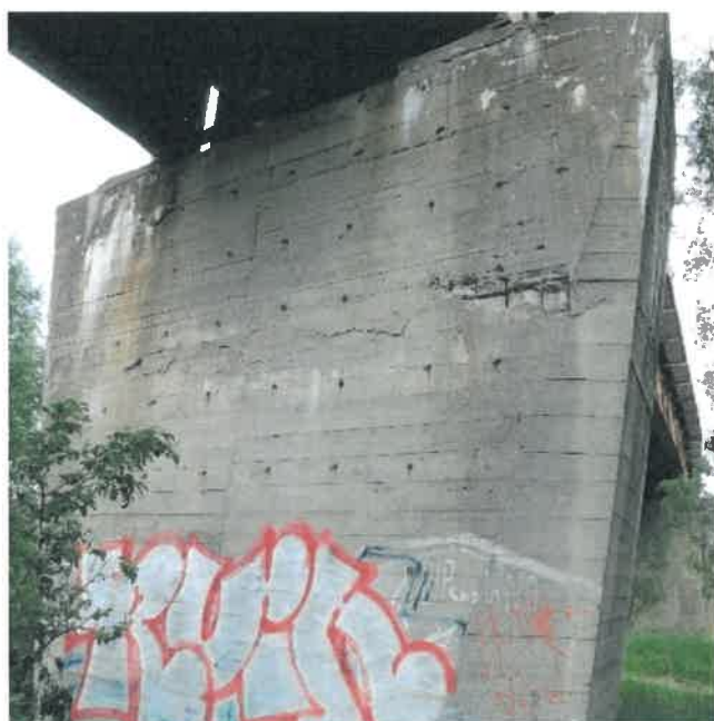
Fot. 111 Widok od strony Tropów. Ubytek betonu z odsłoniętymi i skorodowanymi prętami. Graffiti obniżające estetykę. Osady i wykwyty na betonie, białe przebarwienia betonu.
