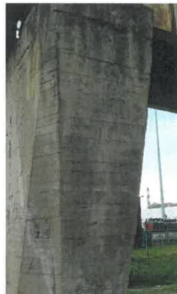
Fot. 122 Widok z prawej strony. Osady na betonie, białe przebarwienia betonu
