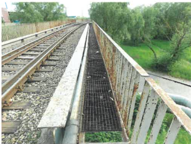
Fot. 178 Widok na nawierzchnię chodnika lewego w przęśle 1. Brak 25 cm długości kraty stanowiącej nawierzchnię chodnika.
