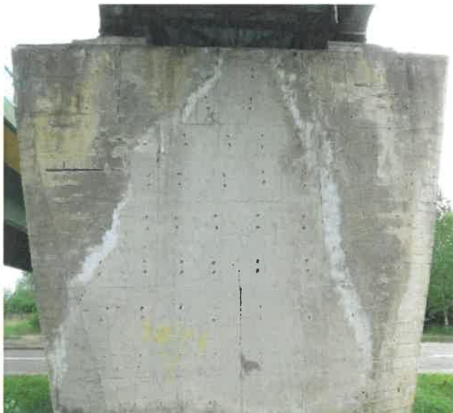
Fot. 121 Widok od strony Braniewa. Osady na betonie, białe przebarwienia betonu. Ubytki betonu wzdłuż korodujących prętów.
