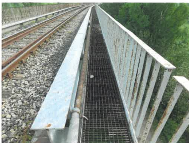
Fot. 176 Widok na nawierzchnię chodnika – przęsło 4, strona lewa. Korozja powierzchniowa kraty stanowiącej jego nawierzchnię.
