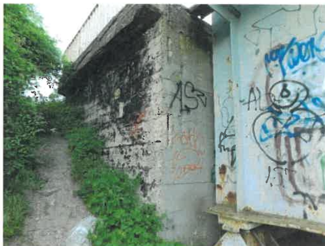
Fot. 169 Skrzydło lewe. Zniszczenie powłoki antykorozyjnej betonu. Krawędziowe ubytki betonu na styku ze ścianką zapleczną z odsłoniętym i skorodowanym prętem.
