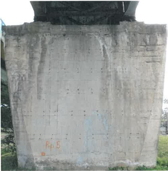
Fot. 125 Widok od strony Braniewa. Osady na betonie, białe przebarwienia betonu. Ubytki betonu wzdłuż korodujących prętów.
