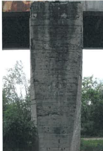
Fot. 118 Widok z prawej strony. Ubytki betonu wzdłuż korodujących prętów poziomych.
