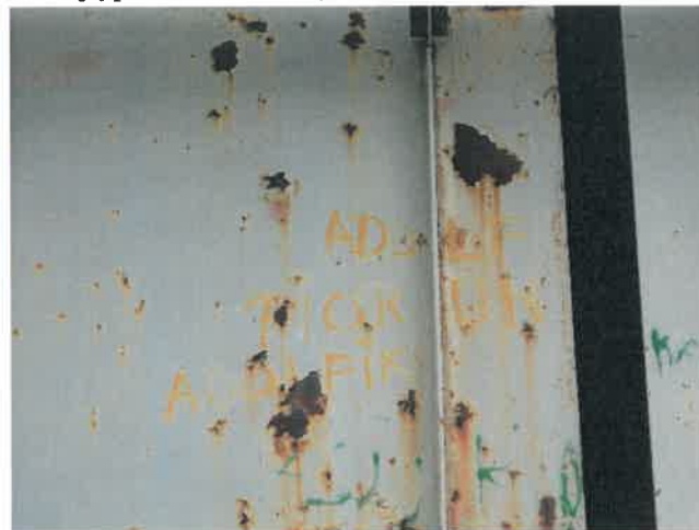
Fot. 50 Widok z boku na środnik blachownicy lewej przęsła 16. Łuszczenie powłoki antykorozyjnej z korozją powierzchniową i drobnymi ogniskami korozji wżerowej.
