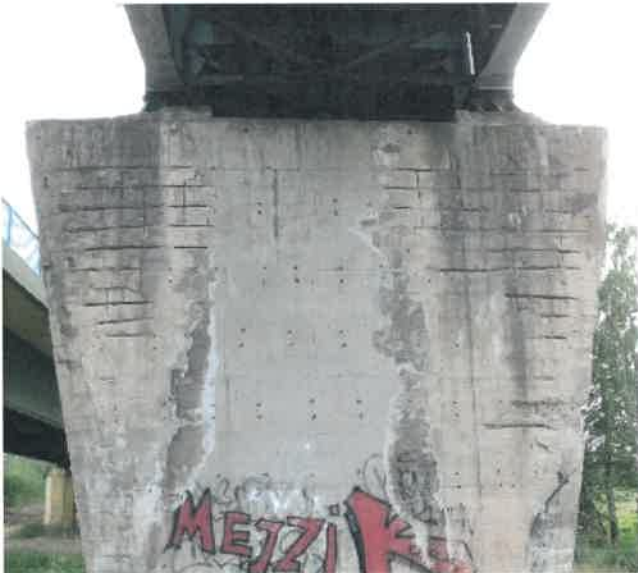
Fot. 117 Widok od strony Braniewa. Graffiti obniżające estetykę. Osady na betonie, białe przebarwienia betonu. Ubytki betonu wzdłuż korodujących prętów poziomych.
