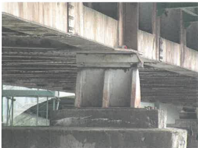
Fot. 95 Widok na łożysko lewe i jego cios na podporze L. Korozja stali.
