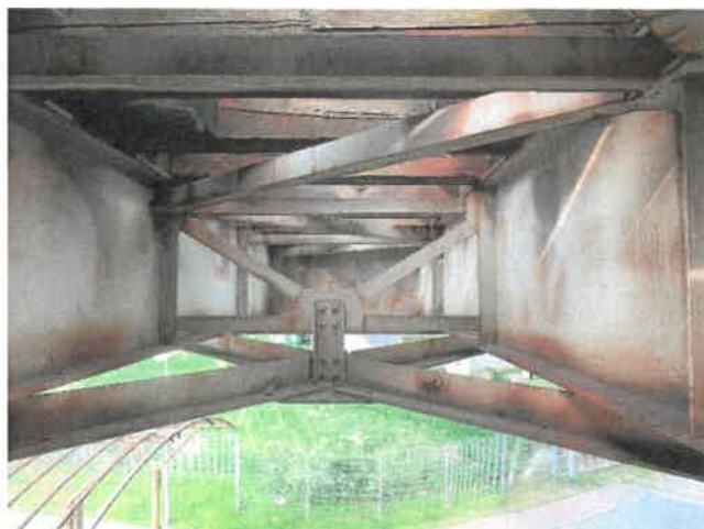
Fot. 74 Widok na podłużnice oraz na stężenia wahaniove w przęśle 11. Drobne ogniska korozji powierzchniowej.
