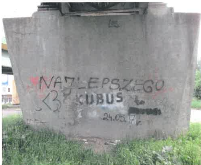
Fot. 156 Widok od strony Braniewa. Graffiti obniżające estetykę. Spękania otuliny betonowej. Drobne osady i białe przebarwienia.
