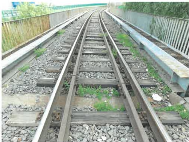
Fot. 81 Widok na nawierzchnię torową w prześle 15. Drobna wegetacja roślinności.
