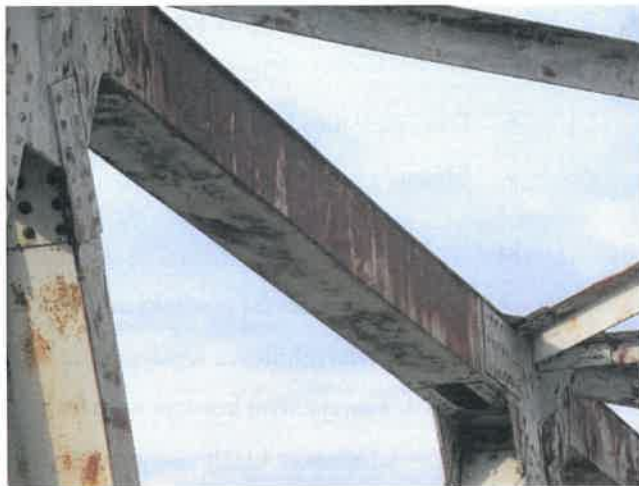
Fot. 56 Pas górny lewego dźwigara kratowego w przęśle 10. Widoczna znaczna korozja powierzchniowa i łuszczenie się powłoki malarskiej.
