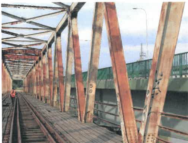
Fot. 55 Krzyżulce prawego dźwigara kratowego w przęśle 11. Widoczna korozja powierzchniowa, łuszczenie się powłoki malarskiej i graffiti.
