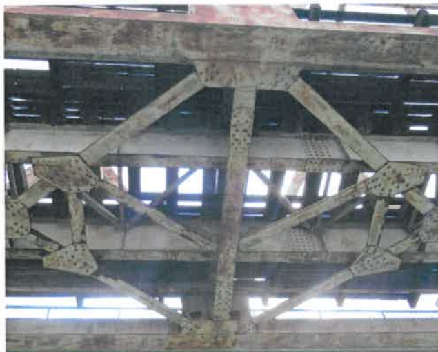
Fot. 76 Widok na stężenie hamowne w przęśle 12. Korozja powierzchniowa z ogniskami korozji wżerowej.
