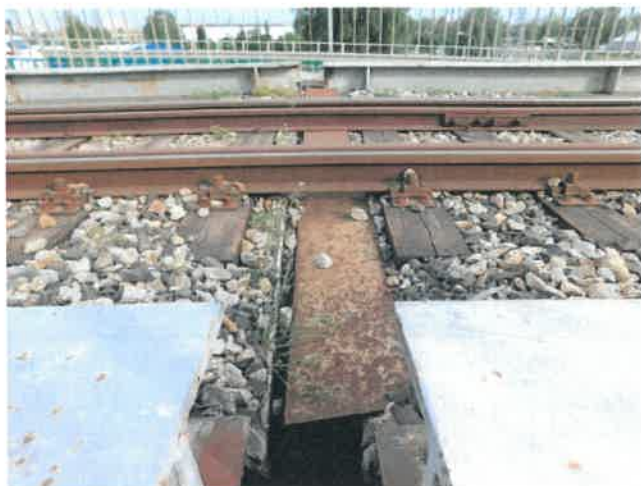
Fot. 188 Widok na blachę przykrywającą szczelinę dylatacyjną pomiędzy przęsłem 4 i 5 (w osi E). Korozja stali i deformacja blachy.
