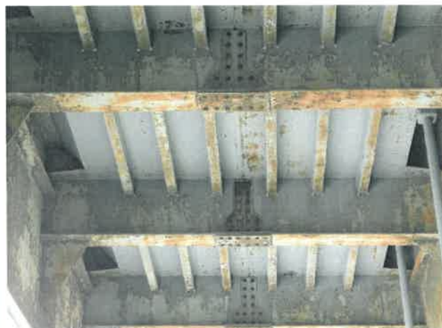
Fot. 70 Łuszczenie powłoki malarskiej na poprzecznicach w przęsle 16 z korozją powierzchniową.
