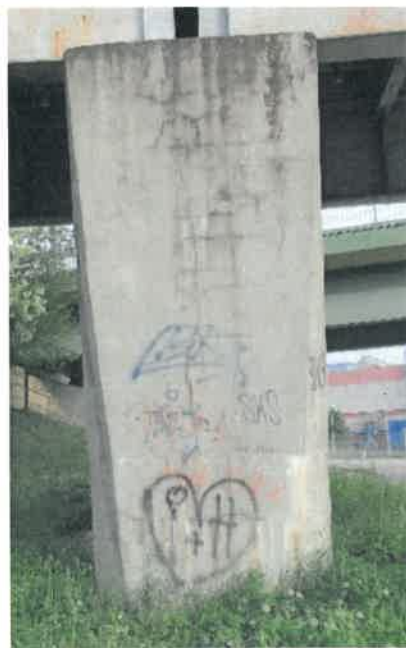
Fot. 159 Widok z lewej strony. Graffiti obniżające estetykę. Spękania otuliny betonowej. Drobne osady i białe przebarwienia.
