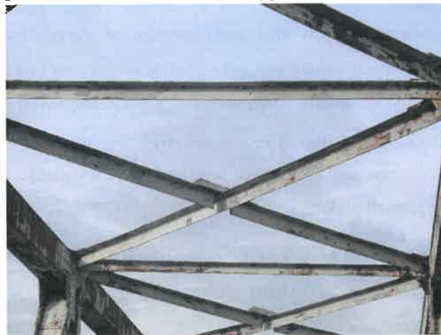
Fot. 58 Stężenie górne wiatrowe w przęśle 10. Widoczna lokalna korozja powierzchniowa i łuszczenie się powłoki malarskiej.
