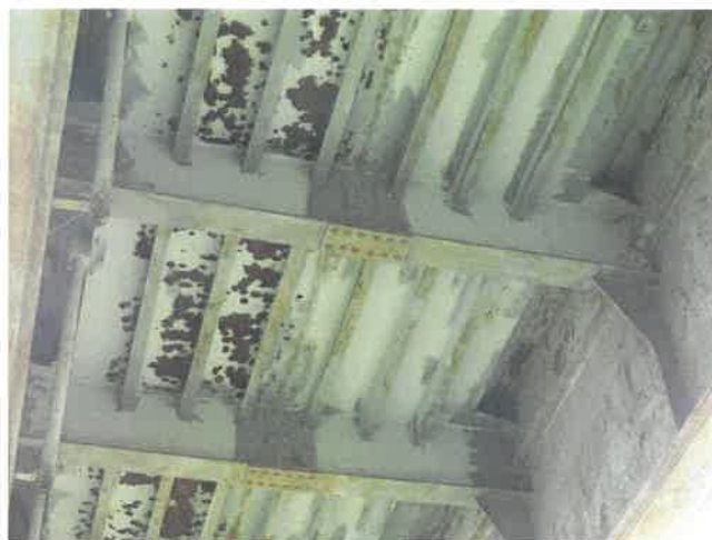
Fot. 72 Korozja powierzchniowa z ogniskami korozji wżerowej na spodzie blachy płyty w przęśle 6.
