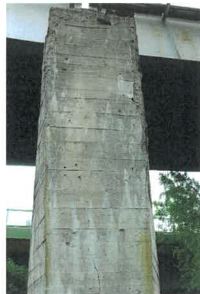
Fot. 116 Widok z lewej strony. Spękania otuliny betonowej. Białe przebarwienia betonu.
