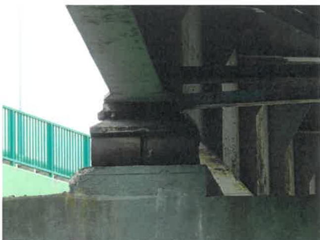
Fot. 97 Widok na łożysko prawe i jego cios na podporze O. Korozja stali. Krawędziowy ubytek betonu.
