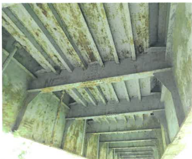
Fot. 67 Widok na spód przęsła 1. Korozja powierzchniowa na poprzecznicach i płycie ortotropowej.
