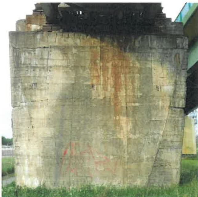
Fot. 138 Widok od strony Tropów. Osady na betonie, białe przebarwienia betonu. Ubytki betonu wzdłuż korodujących prętów.
