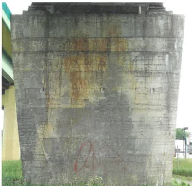
Fot. 136 Widok od strony Braniewa. Osady na betonie, białe przebarwienia betonu.
