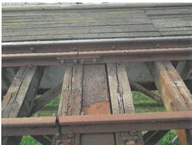
Fot. 85 Widok na mostownice w przęśle 10. Mostownice silnie zbutwiałe i popękane.
