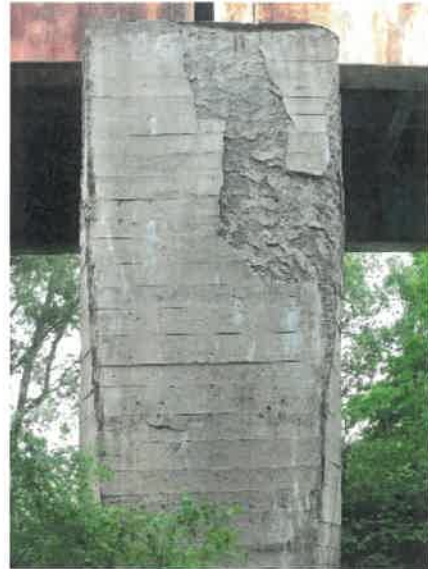
Fot. 114 Widok z prawej strony. Spękania i powierzchniowe ubytki otuliny betonowej. Białe przebarwienia betonu.
