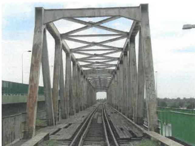
Fot. 53 Rama portalowa kratownicy przęsła 12 nad podporą M. Widoczna korozja powierzchniowa, łuszczenie się powłoki malarskiej i zanieczyszczenie graffiti.
