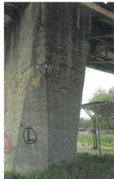
Fot. 147 Widok z prawej strony. Osady i wykwyty na betonie.
