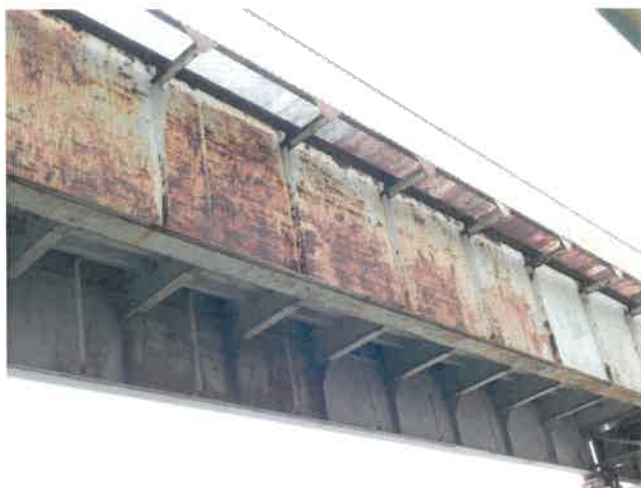
Fot. 47 Widok z boku na przęsło 8 (dźwigar prawy). Korozja powierzchniowa środnika z ogniskami korozji wżerowej.
