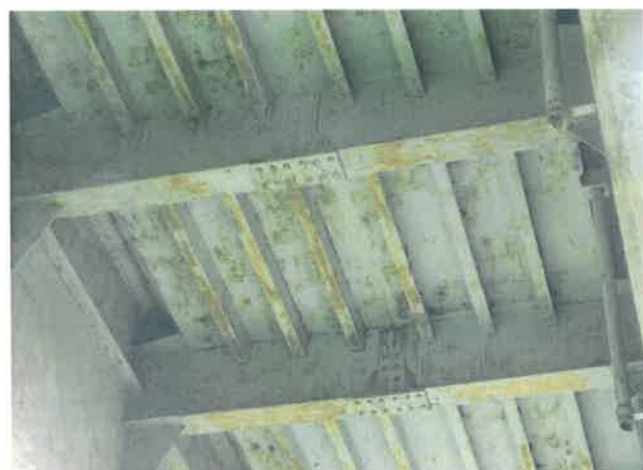
Fot. 69 Widok na spód przęsła 3. Ogniska korozji powierzchniowej na spodzie pasa poprzecznicy i na płycie ortotropowej.
