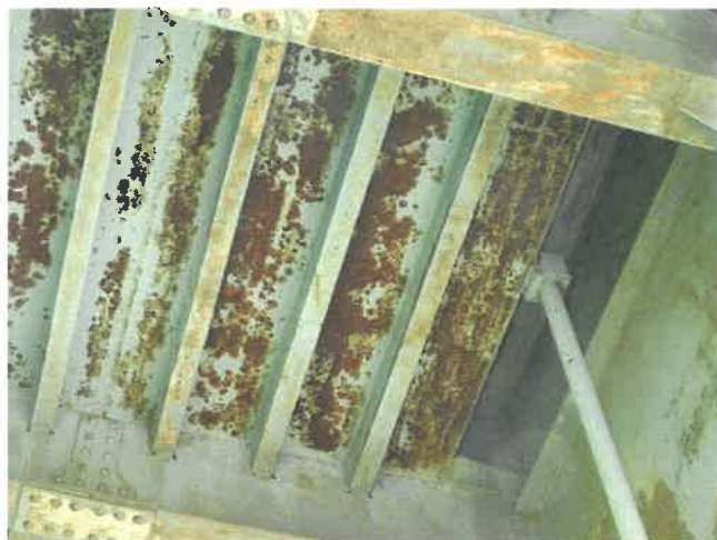
Fot. 71 Rozległa korozja powierzchniowa z ogniskami korozji wżerowej na spodzie blachy płyty w przęśle 16.
