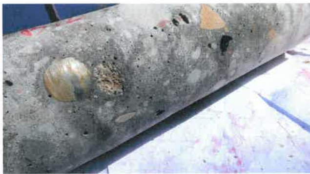
Fot. 19 Zbliżenie na strukturę betonu próbki B.2.
