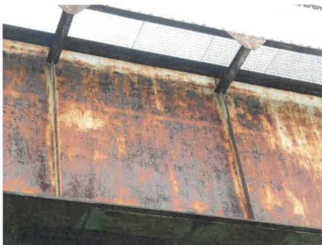
Fot. 43 Widok z boku na przęsło 3 (dźwigar prawy). Korozja powierzchniowa łożyska z ogniskami korozji wżerowej.
