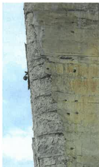
Fot. 131 Widok z lewej strony. Znaczne ubytki powierzchniowe betonu z odkrytą siatką zbrojenia. Korozja betonu.
