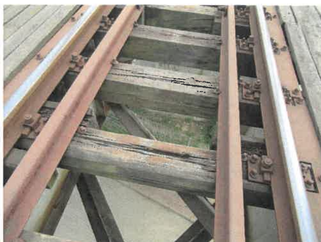
Fot. 88 Widok na mostownice w przęśle 12. Mostownice silnie zbutwiałe i popękane. Luźne mocowania szyn i odbojnic do mostownic.
