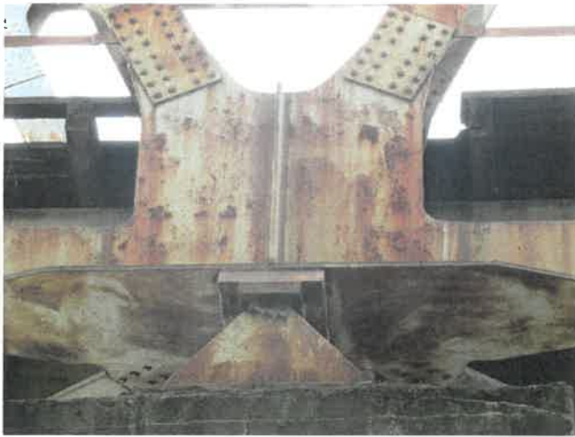
Fot. 61 Połączenie krzyżulców z pasem dolnym nad podporą L. Widoczna korozja powierzchniowa i łuszczenie się powłoki malarskiej.
