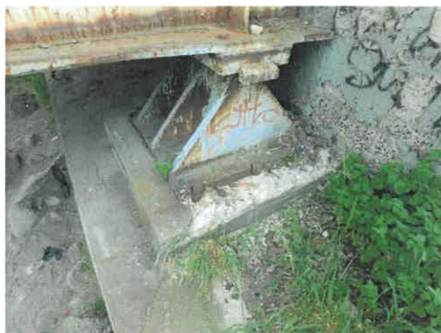
Fot. 100 Widok na łożysko prawe i jego cios na podporze S. Korozja stali. Ubytki betonu ciosu.
