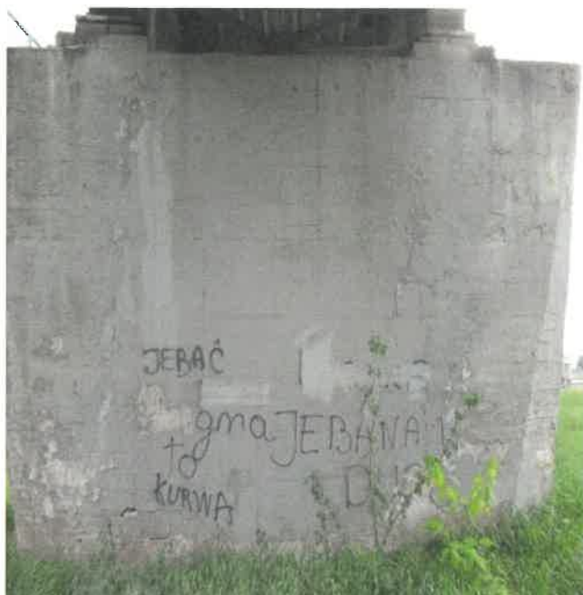
Fot. 152 Widok od strony Braniewa. Graffiti obniżające estetykę. Spękania otuliny betonowej. Drobne osady i białe przebarwienia.
