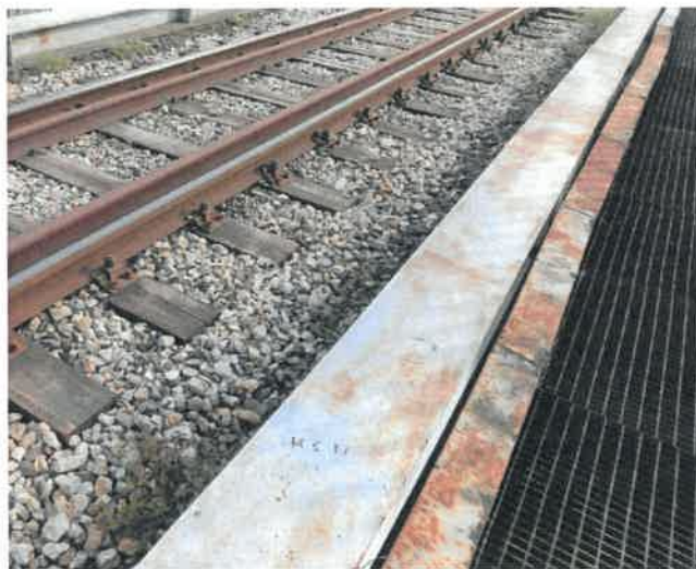
Fot. 48 Widok na pas górny dźwigara lewego przęsła 9. Punktowe zniszczenie powłoki antykorozyjnej z korozją powierzchniową.
