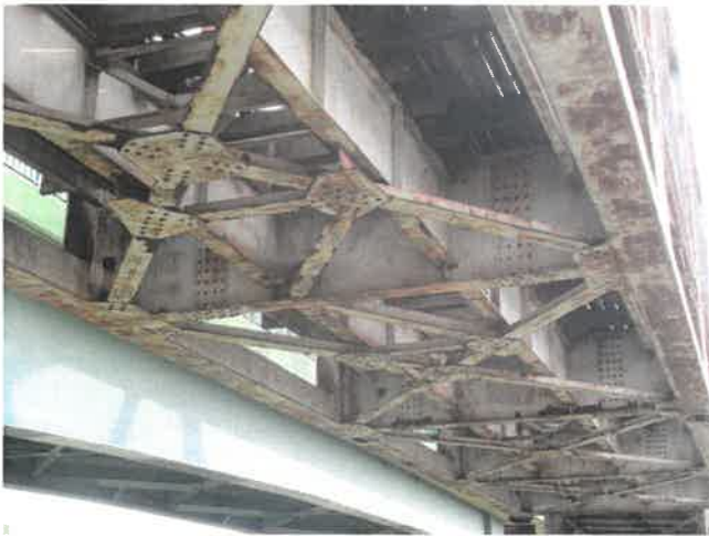
Fot. 63 Widok na stężenia wiatrowe dolne i stężenie hamowne w przęśle 11. Widoczna korozja powierzchniowa i łuszczenie się powłoki malarskiej.
