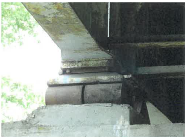
Fot. 99 Widok na łożysko prawe i jego cios na podporze R. Korozja stali. Spękania i
