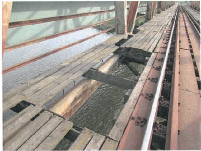
Fot. 181 Widok na chodnik służbowy prawy w przęśle 11. Ubytki desek (dziury), deski i elementy wsporcze (krawędziaki) silnie zbutwiałe.
