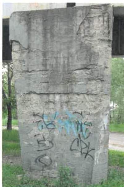
Fot. 163 Widok z prawej strony. Spękania otuliny betonowej. Ubytki powierzchniowe betonu z odkrytą siatką zbrojenia. Korozja betonu.
