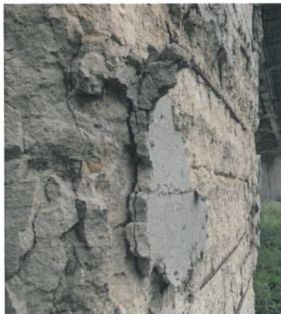
Fot. 151 Zbliżenie na zdegradowany powierzchniowo beton – korozja betonu, beton kruszeje.
