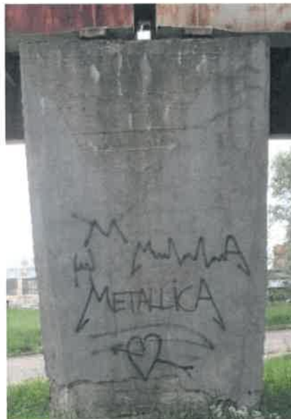
Fot. 157 Widok z prawej strony. Graffiti obniżające estetykę. Spękania otuliny betonowej. Drobne osady i białe przebarwienia. Powierzchniowe ubytki wierzchniej warstwy betonu.
