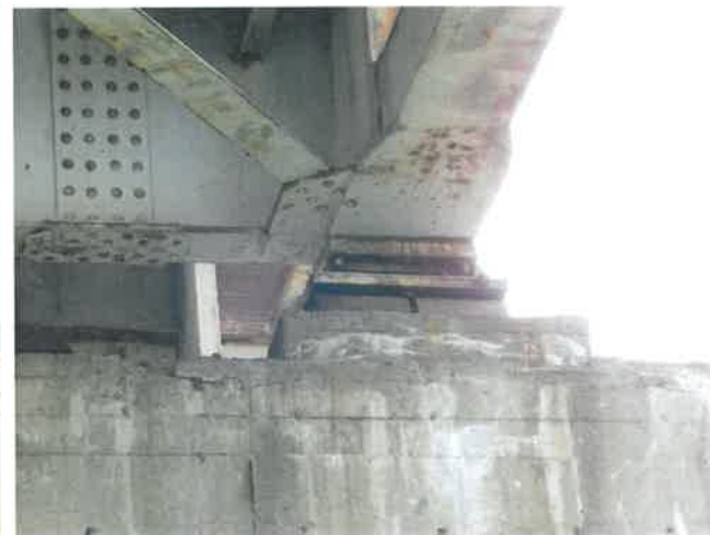
Fot. 94 Widok na łożysko lewe i jego cios na podporze J (pod przęsłem kratowym). Korozja stali.
