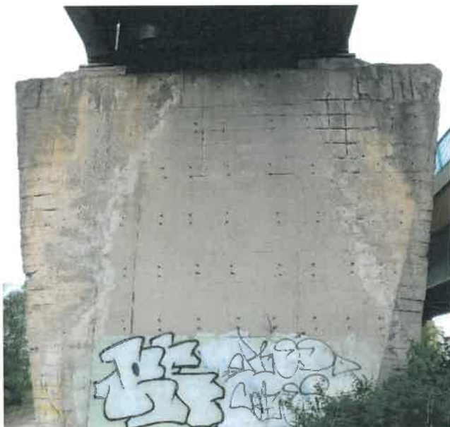
Fot. 119 Widok od strony Tropów. Graffiti obniżające estetykę. Osady na betonie, białe przebarwienia betonu. Ubytki betonu wzdłuż korodujących prętów poziomych.
