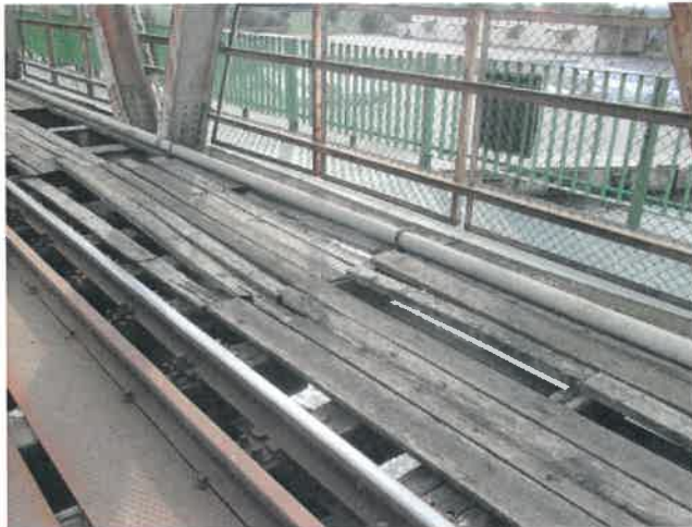
Fot. 182 Widok na chodnik służbowy lewy w przęśle 11. Ubytki desek (dziury), deski zbutwiałe.
