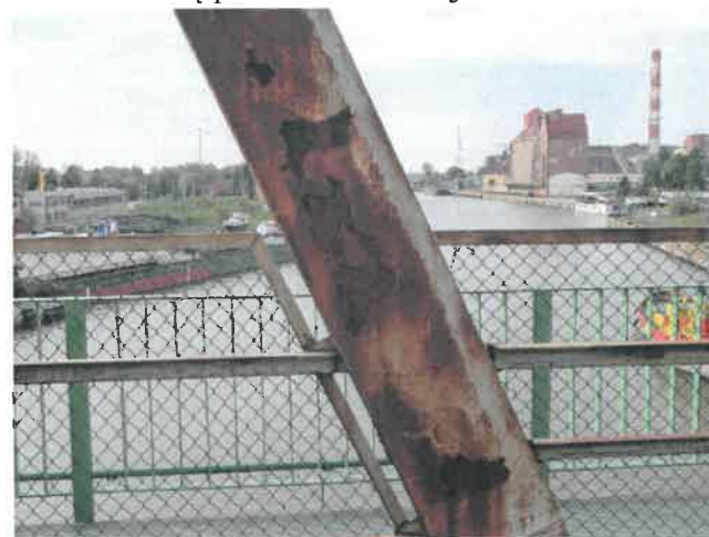
Fot. 59 Zbliżenie na krzyżulec dźwigara lewego w przęśle 11. Widoczna korozja powierzchniowa i łuszczenie się powłoki malarskiej.
