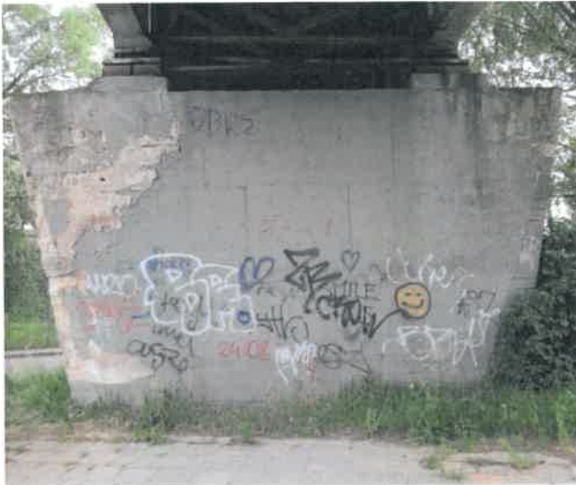
Fot. 164 Widok od strony Braniewa. Spękania otuliny betonowej. Ubytki powierzchniowe betonu.
