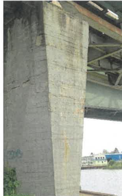
Fot. 145 Widok z lewej strony. Osady na betonie.
