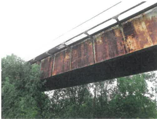
Fot. 41 Widok z boku na przęsło 1 (dźwigar prawy). Korozja powierzchniowa łożyska z ogniskami korozji wżerowej.
