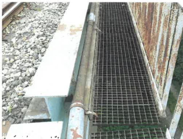
Fot. 179 Widok na nawierzchnię chodnika lewego na styku przęsła 4 i 3. Deformacja kraty stanowiącej nawierzchnię chodnika.
