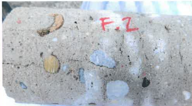
Fot. 21 Zbliżenie na strukturę betonu próbki F.2.
