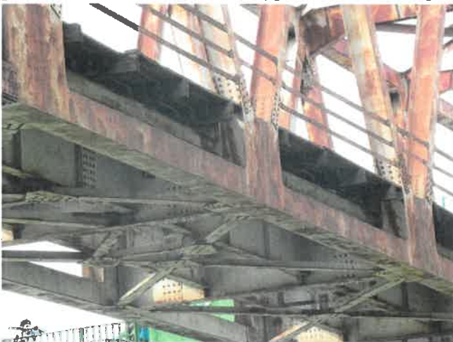
Fot. 65 Pas dolny prawego dźwigara kratowego w przęśle 10. Widoczna korozja powierzchniowa i łuszczenie się powłoki malarskiej.
