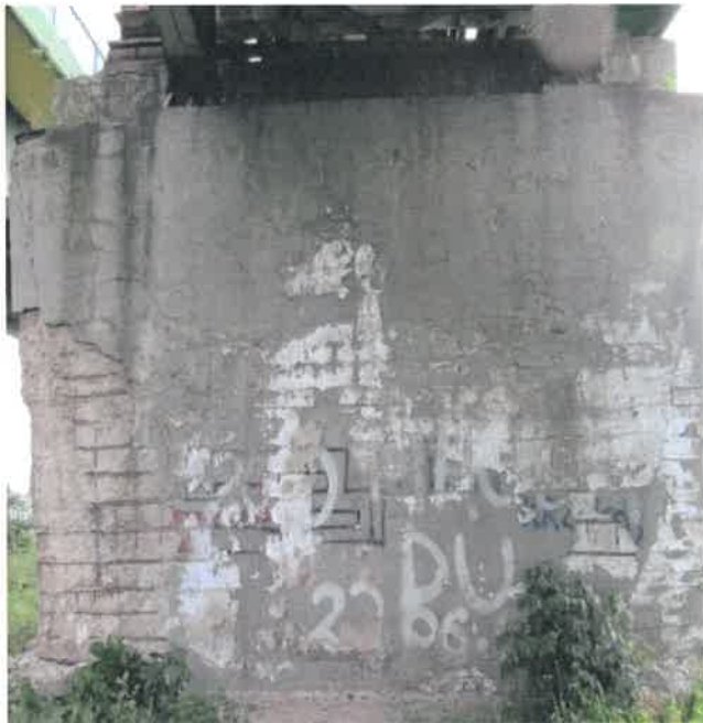
Fot. 148 Widok od strony Braniewa. Spękania otuliny betonowej. Znaczne ubytki powierzchniowe betonu z odkrytą siatką zbrojenia. Korozja betonu.
