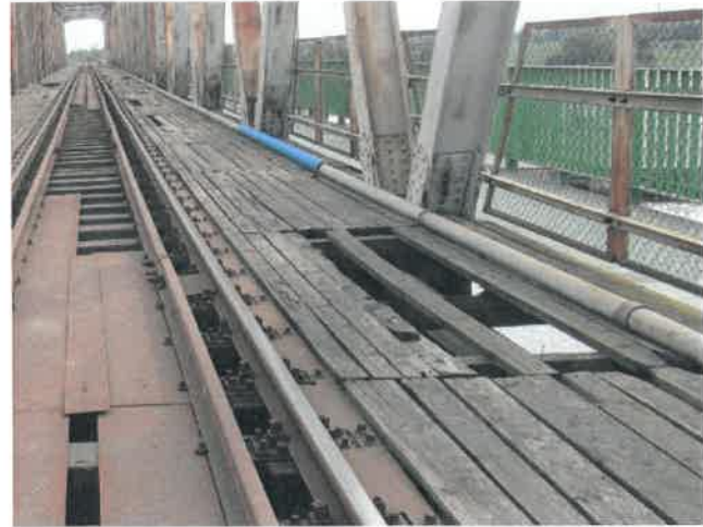
Fot. 183 Widok na chodnik służbowy lewy w przęśle 12. Ubytki desek (dziury), deski zbutwiałe.
