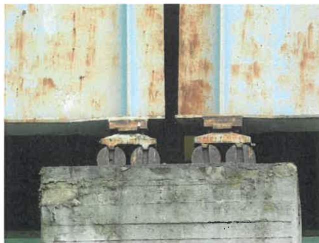
Fot. 96 Widok na łożyska lewa na podporze N. Korozja stali.
