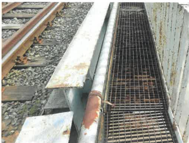
Fot. 184 Widok na rurę ochronną kabli SRK ułożoną na chodniku służbowym przęsła 14 blachownicowego.
