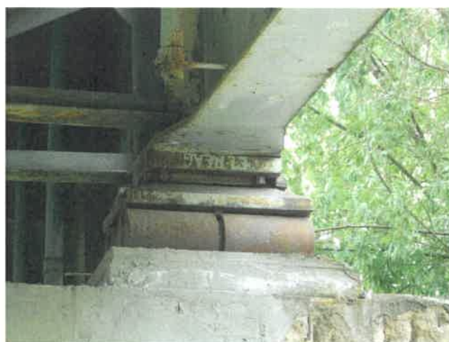
Fot. 98 Widok na łożysko lewe i jego cios na podporze P. Korozja stali.
