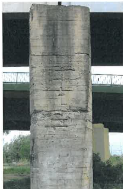
Fot. 120 Widok z lewej strony. Ubytki betonu wzdłuż korodujących prętów poziomych.
