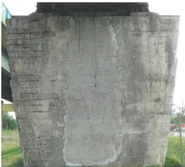
Fot. 128 Widok od strony Braniewa. Osady na betonie, białe przebarwienia betonu. Ubytki betonu wzdłuż korodujących prętów.
