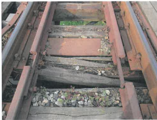
Fot. 84 Widok na skrajną mostownicę przęsła 10 przy przęsła blachownicowym. Mostownica silnie zbutwiała i załamana.
