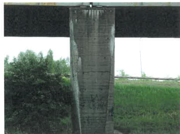
Fot. 108 Widok z lewej strony. Białe przebarwienia betonu.
