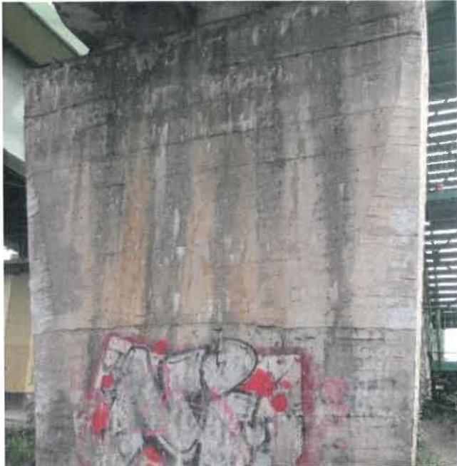
Fot. 140 Widok od strony Braniewa. Graffiti obniżające estetykę. Spękania otuliny betonowej. Osady na betonie, białe przebarwienia betonu.
