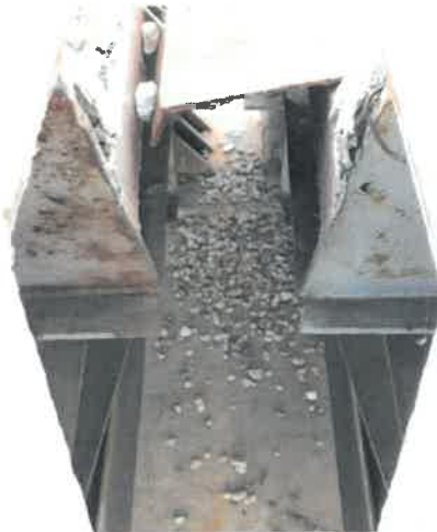
Fot. 189 Widok na zanieczyszczoną lawę podłożyskową podpory w osi E obsypującym się tłuczniem jako skutek uszkodzenia opisanego powyżej.
