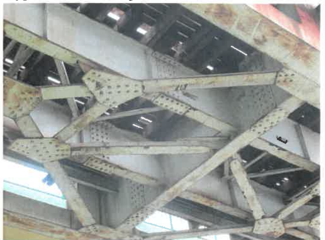
Fot. 66 Stężenie dolne hamowne w przęśle 12. Widoczna miejscowa korozja powierzchniowa i łuszczenie się powłoki malarskiej.
