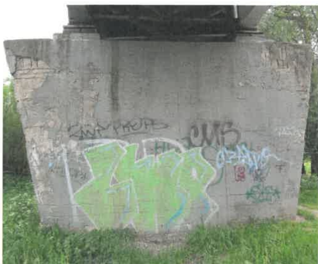
Fot. 160 Widok od strony Braniewa. Spękania otuliny betonowej. Ubytki powierzchniowe betonu z odkrytą siatką zbrojenia. Korozja betonu.
