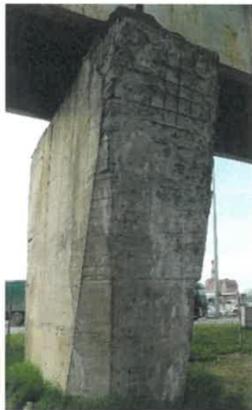
Fot. 129 Widok z prawej strony. Znaczne ubytki powierzchniowe betonu z odkrytą siatką zbrojenia. Korozja betonu.
