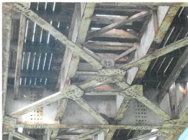
Fot. 73 Widok na spód przęsła 10. Korozja powierzchniowa z ogniskami korozji wżerowej na elementach jezdni.
