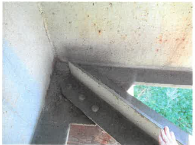
Fot. 62 Węzeł dolny kratownicy w przęśle 12 nad podporą M. Widoczna miejscowa powierzchniowa korozja i drobne zanieczyszczenie węzła.
