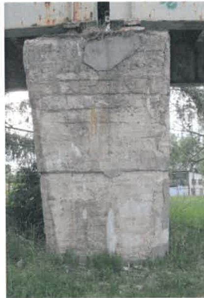
Fot. 165 Widok z prawej strony. Spękania otuliny betonowej. Ubytki powierzchniowe betonu z odkrytą siatką zbrojenia. Korozja betonu.
