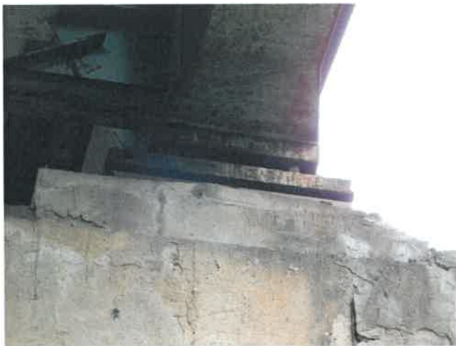
Fot. 91 Widok na łożysko prawe i jego cios na podporze E. Korozja stali, krawędziowe ubytki betonu ciosu.
