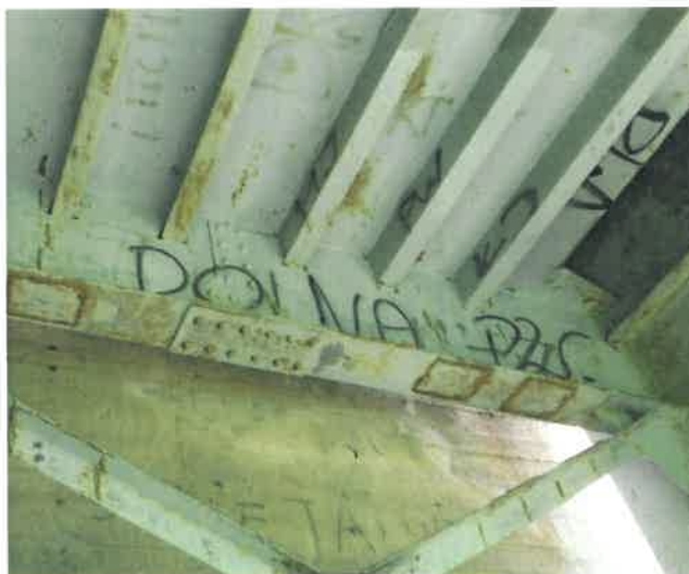
Fot. 68 Zanieczyszczenie w postaci nieestetycznego graffiti na poprzecznicy i blasze płyty w przęsle 1.
