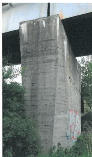
Fot. 112 Widok z lewej strony. Osady na betonie, białe przebarwienia betonu.
