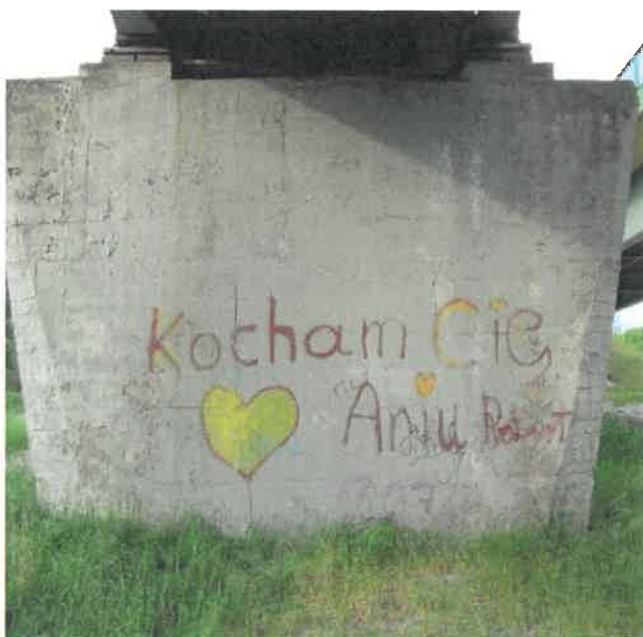
Fot. 154 Widok od strony Tropów. Graffiti obniżające estetykę. Spękania otuliny betonowej. Drobne osady i białe przebarwienia.
