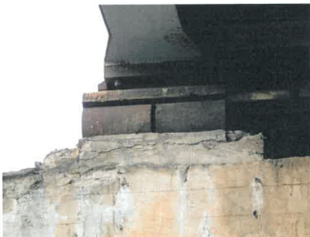
Fot. 93 Widok na łożysko lewe i jego cios na podporze I. Korozja stali, krawędziowe ubytki betonu ciosu.
