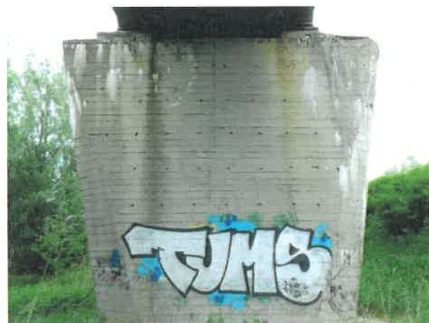
Fot. 107 Widok od strony Tropów. Graffiti obniżające estetykę. Osady i wykwity na betonie, białe przebarwienia betonu.
