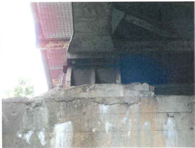
Fot. 90 Widok na łożysko lewe i jego cios na podporze C. Korozja stali, krawędziowe ubytki betonu ciosu.
