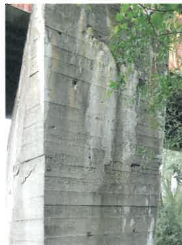
Fot. 110 Widok z prawej strony. Osady na betonie, białe przebarwienia betonu.
