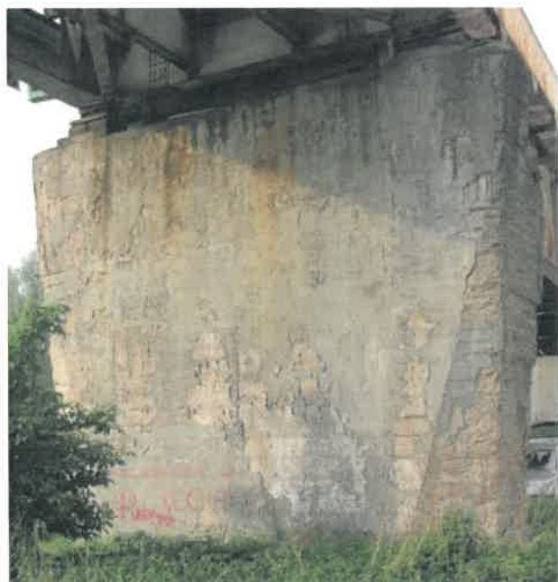
Fot. 150 Widok od strony Tropów. Spękania otuliny betonowej. Znaczne ubytki powierzchniowe betonu.
