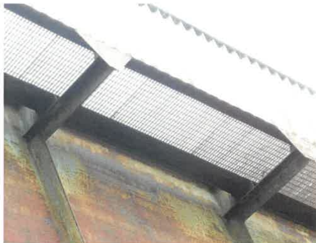
Fot. 177 Widok na konstrukcję wsporczą chodnika – przęsło 5. Korozja powierzchniowa.
