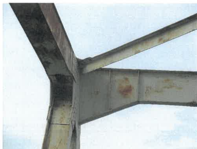
Fot. 54 Węzeł górny ramy portalowej w przęsła 12 nad podporą M. Widoczna korozja powierzchniowa i łuszczenie się powłoki malarskiej.
