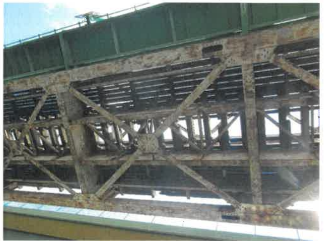
Fot. 64 Widok na stężenie dolne wiatrowe w przęśle 12. Widoczna korozja powierzchniowa i łuszczenie się powłoki malarskiej.
