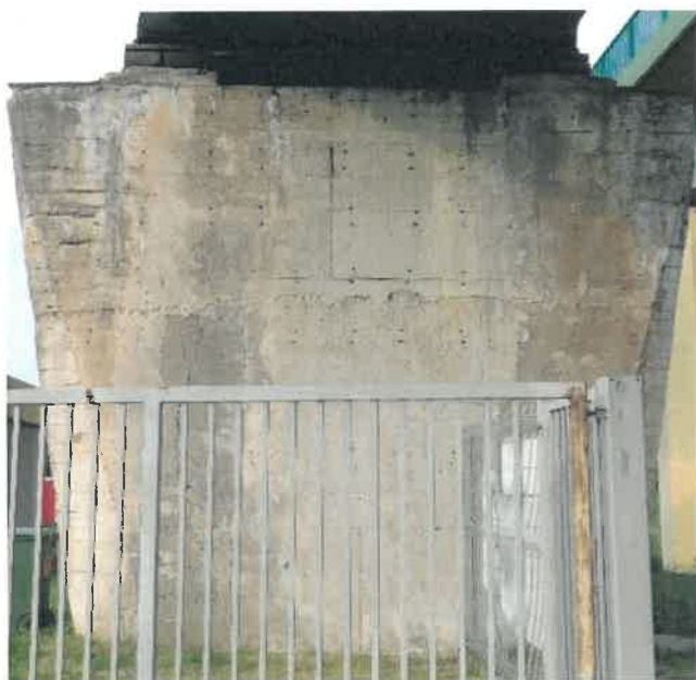
Fot. 134 Widok od strony Tropów. Osady na betonie, białe przebarwienia betonu. Ubytki betonu wzdłuż korodujących prętów.
