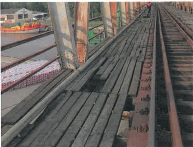
Fot. 180 Widok na chodnik służbowy lewy w przęśle 10. Ubytki desek (dziury), deski zbutwiałe.
