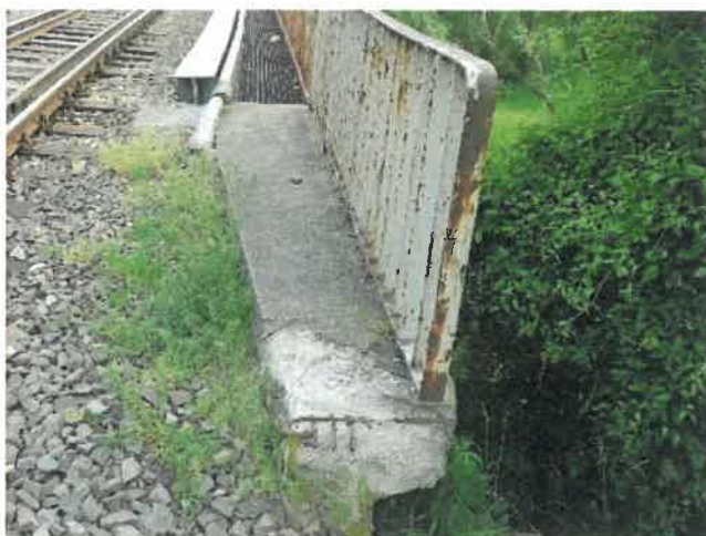
Fot. 171 Widok na gzyms lewy. Ubytek betonu z odsłoniętym i skorodowanym zbrojeniem.
