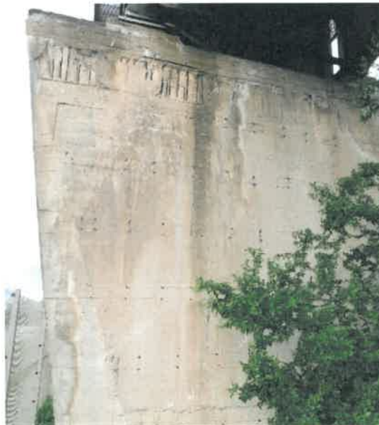
Fot. 127 Widok od strony Tropów. Osady na betonie, białe przebarwienia betonu. Ubytki betonu wzdłuż korodujących prętów.
