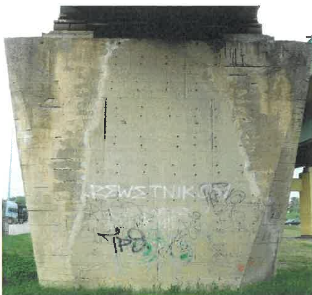
Fot. 123 Widok od strony Tropów. Graffiti obniżające estetykę. Osady na betonie, białe przebarwienia betonu. Ubytki betonu wzdłuż korodujących prętów.
