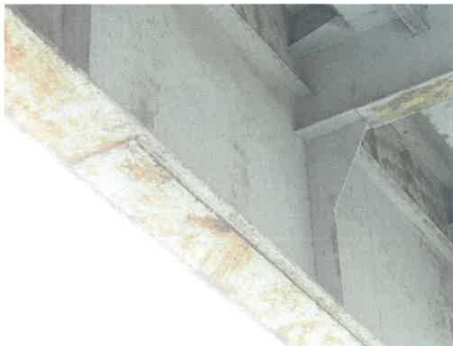
Fot. 45 Widok na spód blachownicy lewej przęsła 5. Korozja powierzchniowa pasa dolnego.
