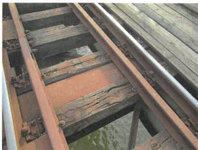
Fot. 86 Widok na mostownice w przęśle 11. Mostownice silnie zbutwiałe i popękane. Luźne mocowania szyn i odbojnic do mostownic.
