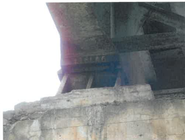
Fot. 92 Widok na łożysko prawe i jego cios na podporze F. Korozja stali, krawędziowe ubytki betonu ciosu.
