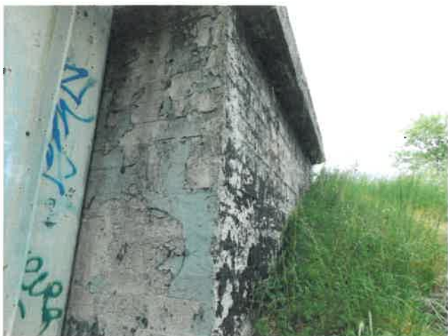
Fot. 170 Skrzydło prawe. Zniszczenie powłoki antykorozyjnej betonu.
