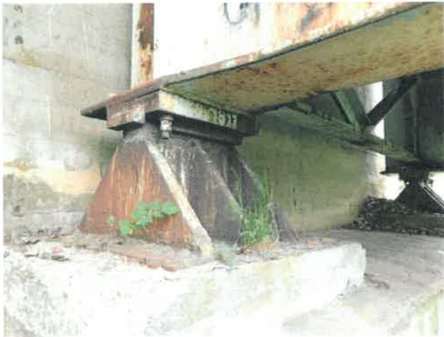
Fot. 89 Widok na łożysko prawe i jego cios na przyczółku A. Korozja stali, krawędziowe ubytki betonu ciosu.
