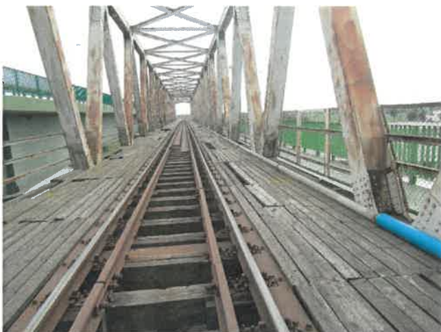
Fot. 87 Widok na nawierzchnię torową w przęśle 12. Znaczne braki blach przeciwwykolejenionych i przeciwpożarowych.
