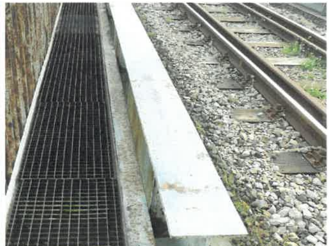
Fot. 46 Widok na pas górny dźwigara prawego przęsła 6. Punktowe zniszczenie powłoki antykorozyjnej z korozją powierzchniową.
