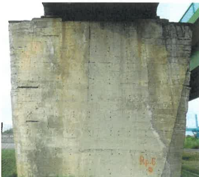
Fot. 130 Widok od strony Tropy. Osady na betonie, białe przebarwienia betonu. Ubytki betonu wzdłuż korodujących prętów.
