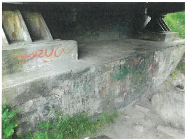
Fot. 168 Widok na korpus. Graffiti obniżające estetykę.
