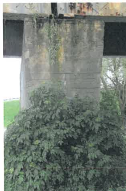
Fot. 167 Widok z lewej strony. Osady i wykwity na betonie.
