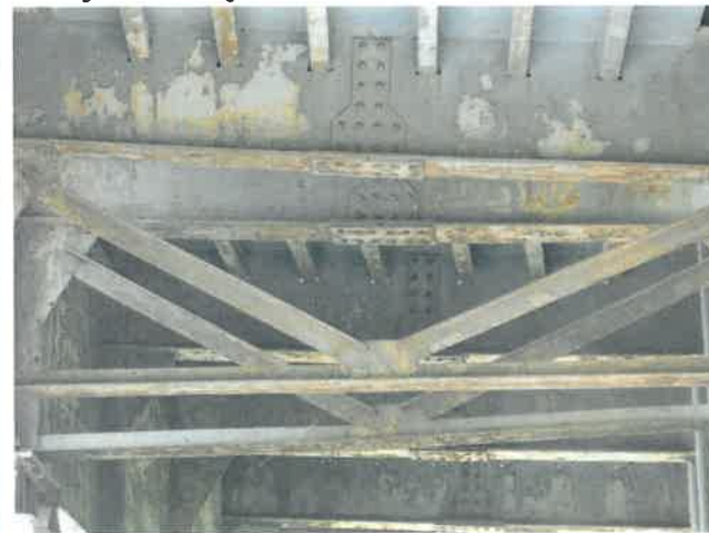
Fot. 52 Widok na stężenie pionowe dźwigarów nad podporą w osi R (pomiędzy przęsłem 16 i 17). Łuszczenie powłoki malarskiej z korozją powierzchniową.
