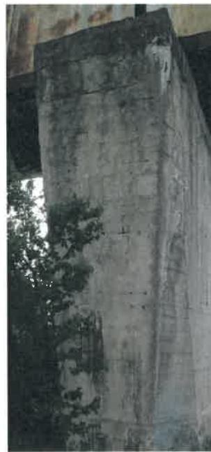
Fot. 126 Widok z prawej strony. Osady na betonie, białe przebarwienia betonu. Spękania otuliny betonowej.
