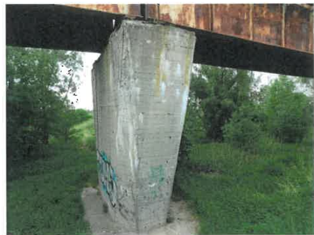
Fot. 106 Widok z prawej strony. Białe przebarwienia betonu.
