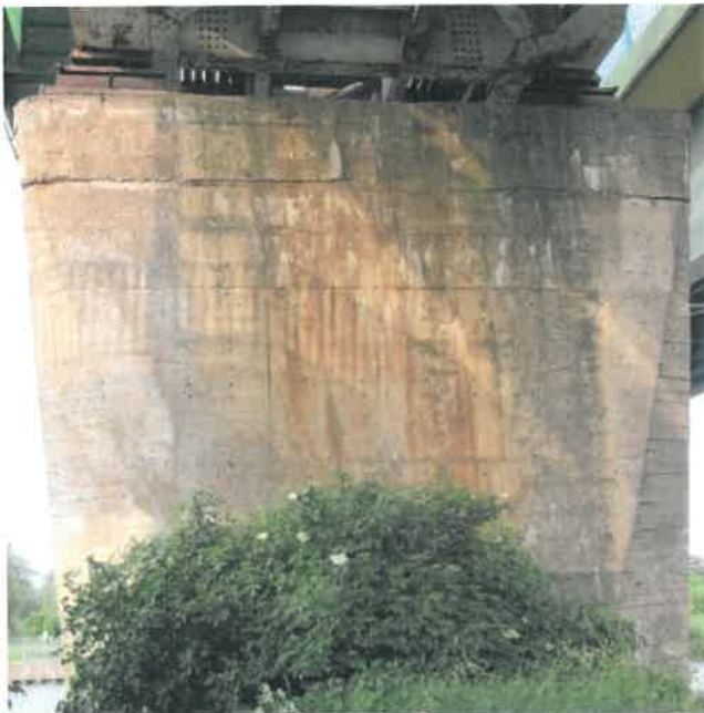
Fot. 142 Widok od strony Tropów. Spękania otuliny betonowej. Osady na betonie, białe przebarwienia betonu.
