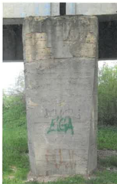
Fot. 161 Widok z lewej strony. Spękania otuliny betonowej. Ubytki powierzchniowe betonu z odkrytą siatką zbrojenia. Korozja betonu.
