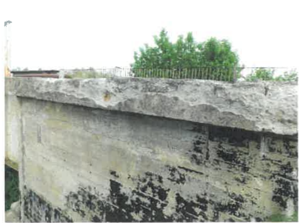
Fot. 104 Widok na skrzydło lewe. Ubytki betonu na gzymsie.
