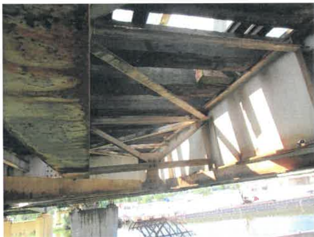
Fot. 75 Widok na spód pasa dolnego podłużnicy w przęśle 12. Korozja powierzchniowa z ogniskami korozji wżerowej na jego spodzie.
