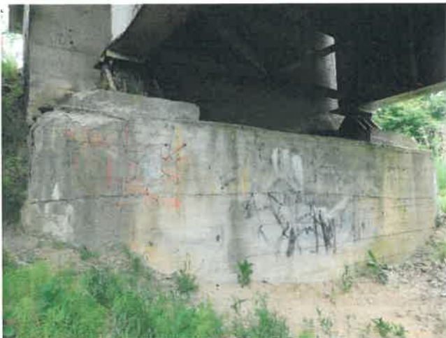
Fot. 101 Widok na korpus. Graffiti obniżające estetykę.
