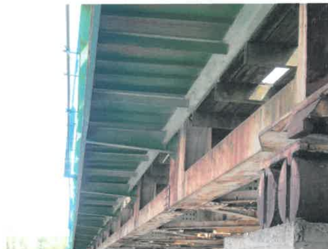
Fot. 190 Widok na spód konstrukcji kładki dla pieszych. Drobne łuszczenia powłoki malarskiej na spodzie blachy pomostu z korozją powierzchniową.
