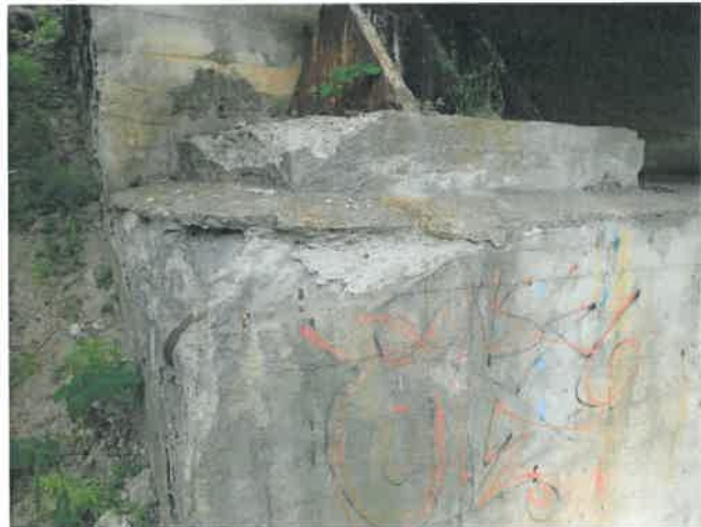
Fot. 102 Widok na prawe naroże korpusu. Krawędziowe ubytki betonu.
