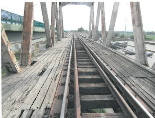
Fot. 83 Widok ogólny na nawierzchnię torową w przęsła 10. Całkowity brak blach przeciwpożarowych.
