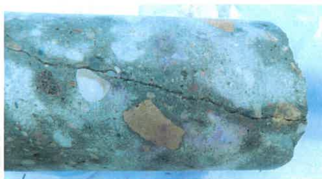
Fot. 17 Zbliżenie na strukturę betonu próbki B.1.
