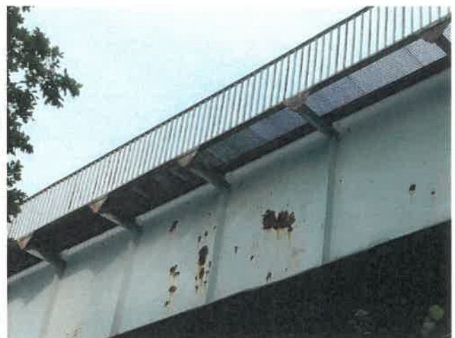
Fot. 44 Widok z boku na przęsło 4 (dźwigar lewy). Punktowe zniszczenie powłoki antykorozyjnej z korozją powierzchniową.
