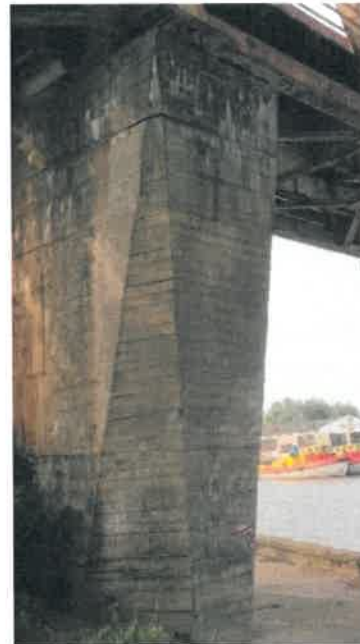
Fot. 141 Widok z prawej strony. Osady na betonie, białe przebarwienia betonu.
